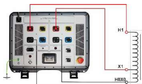
Conexión del TWR-B a un autotransformador monofásico
